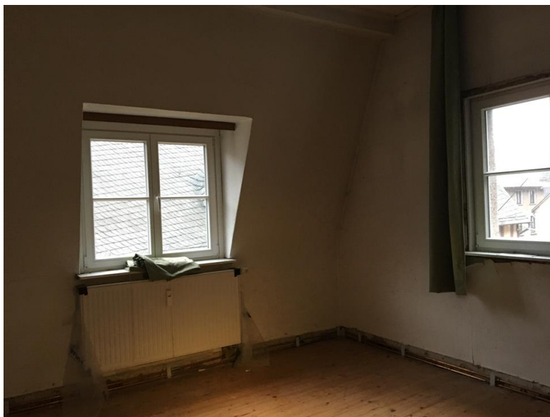
Ungenutzter Wohnraum im Dachgeschoss
