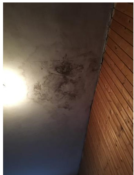
Wasserschaden im Treppenhaus
