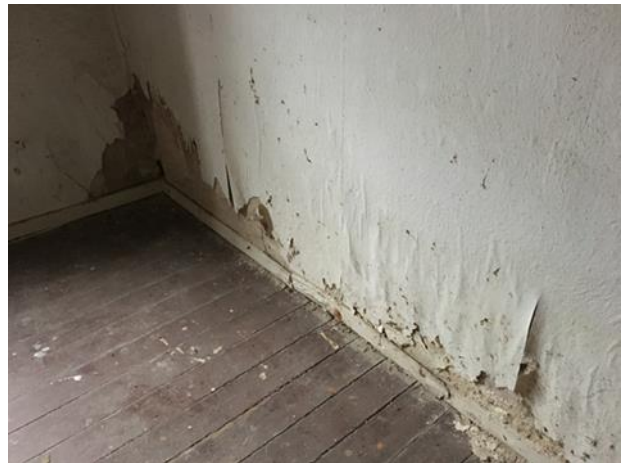
Feuchteschäden Wände OG Wohnung link
