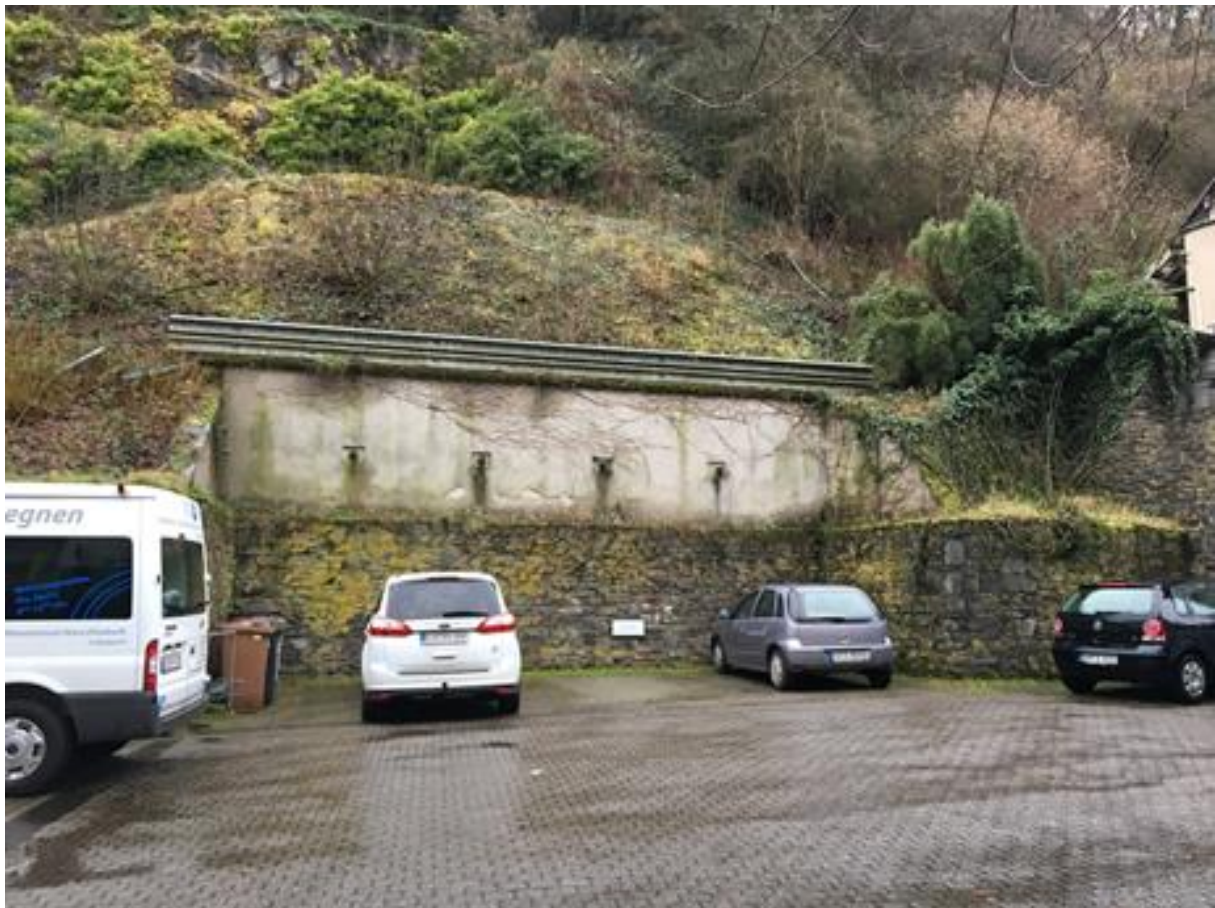
Hangsicherung Parkplatz ehemalige Volksbank.
